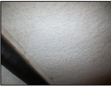
Photo N° 614 ECH-N°1 FLOCAGE -- COULOIR DE CAVE Plafonds blanc cotonneux
